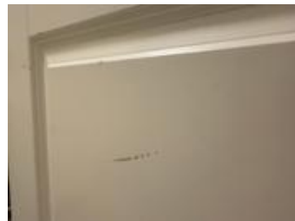
Slitasje/bruksmerke på innerdør til vaskerom.
