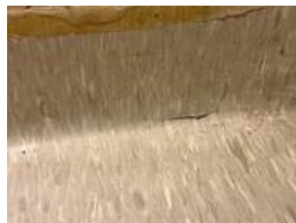
Rift i våtromsbelegg i overgang gulv - vegger.
