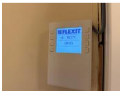
Bryterpanel v/ aggregat. Bør stå på maks effekt v/ dusjing.
