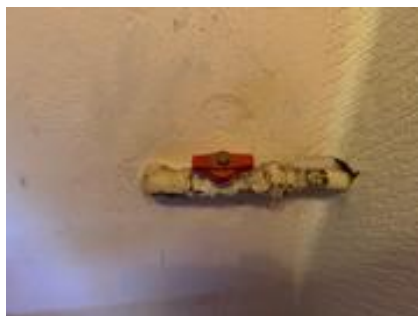
Stoppekran i entre.
