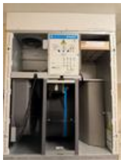
Luftbehandlingsaggregat bak deksel.
