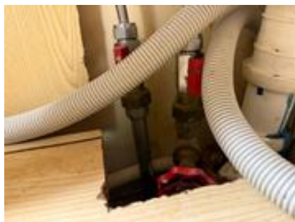
Stoppekraner i kjøkkenskap.
