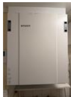
Luftbehandlingsaggregat på vaskerom.
