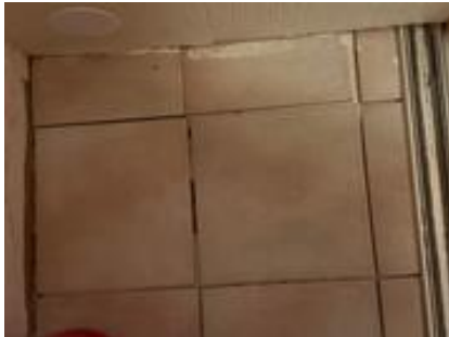
Noen gulvfliser inni skyvedørgarderobe i entre er ikke festet til underlaget.
