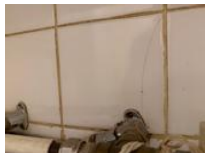
Sprekk i veggflis.
