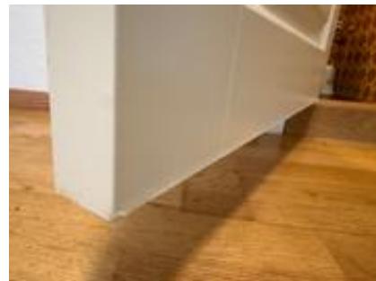
Fuktutsvelling/slitasje i nedre del av badedør.
