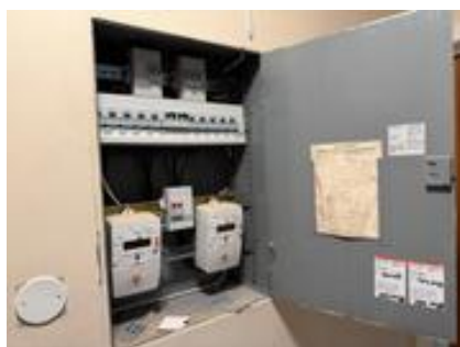
Sikringsskap i fellesarealer.
