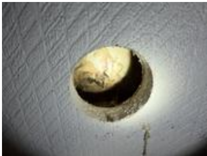
Soppdannelse på gips inni vegg mellom entre bad.
