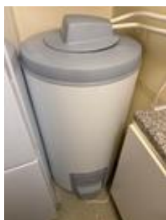
Varmtvannstank på vaskerom.
