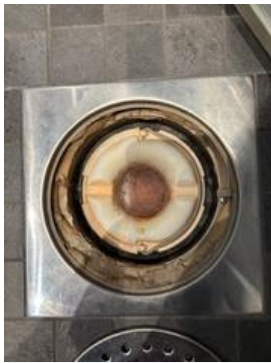
Baderomssluk plassert i dusjsone.
