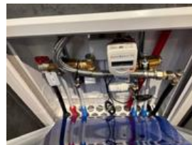
Rørfordeling vannbåren varme plassert i vegg på bad/vaskerom.
