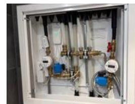
Rerfordelerskap plassert i vegg til bad/vaskerom med vannmåler og stoppekran.
