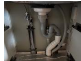
Avløpsrør i underskap vask på kjøkkenet.
