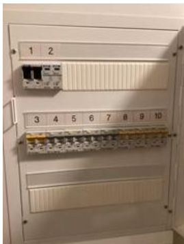
Sikringskap med automatsikringer plassert i skap i entre
