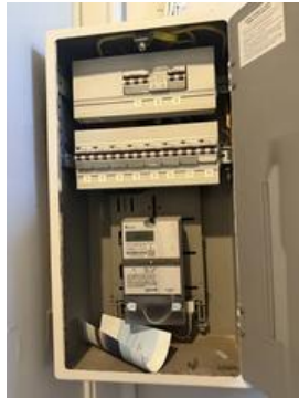
Sikringskapet er montert i felles gang.
