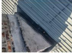
Bildet viser midlertidig tetting på løst anstips.
