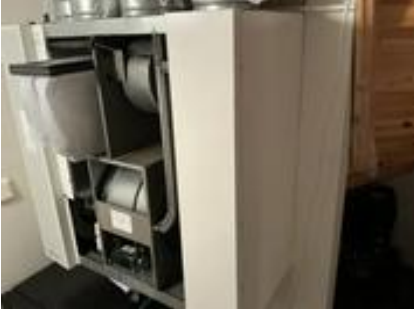
Aggregat står i bod under trapp.
