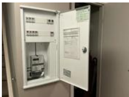
Sikringskap står i entre/gang.
