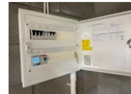
Sikringskap i garasje.
