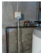
Varmtvannstank er fast tilkoblet.
