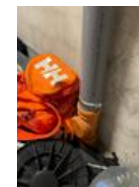
Stakeluke er plassert i bod i kjeller.
