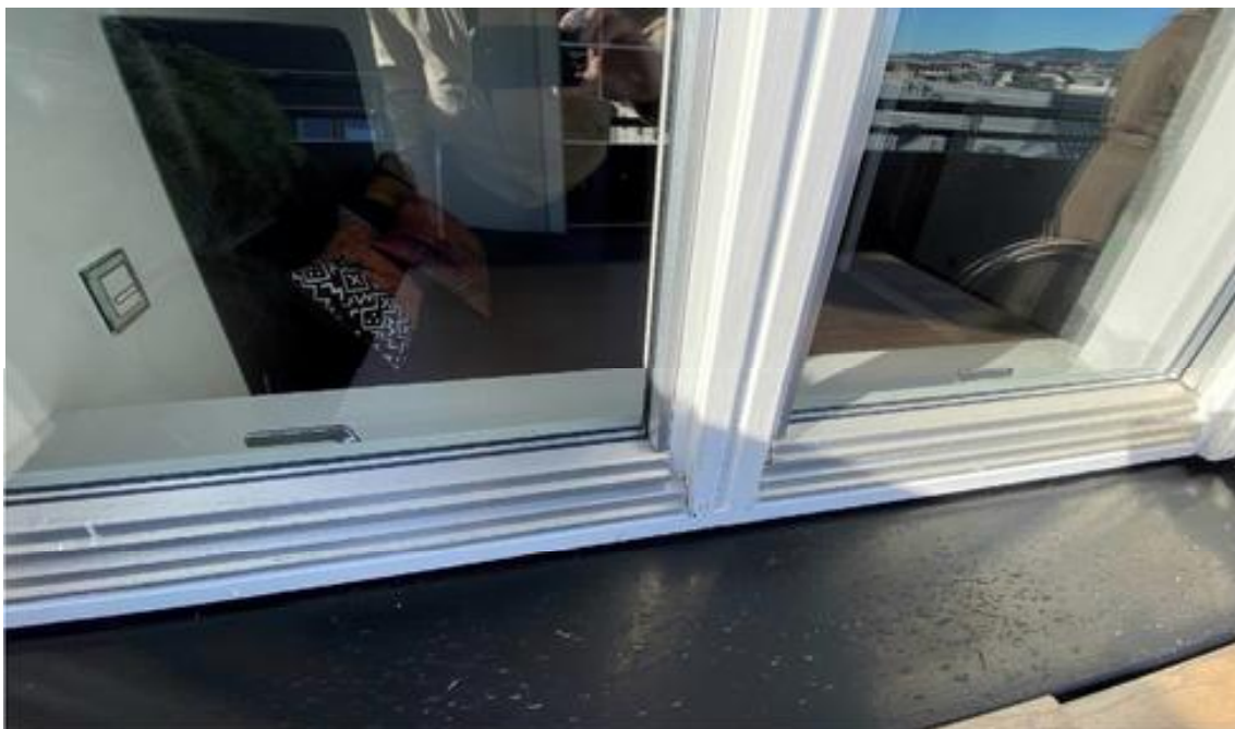
Vinduer fra 1989 med mangler i overfaltebehandling. Vinduer over normal brukstid
