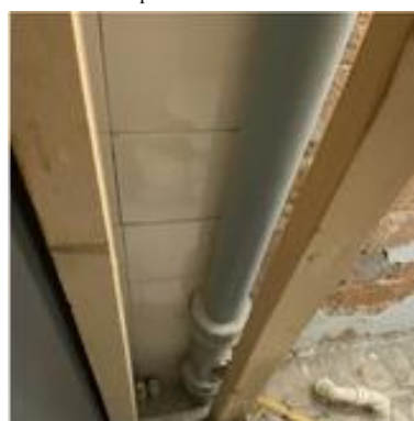
Viser gamle stigerør ikke blir skiftet ut.
