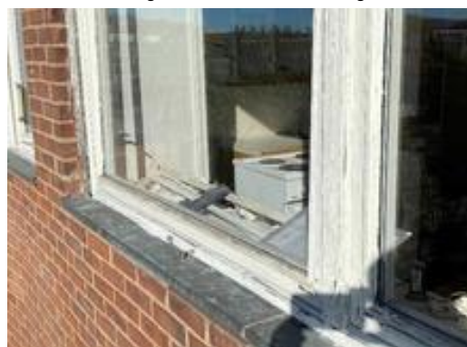
Vinduer mot bakgård i 9 etasje. Store mangler
