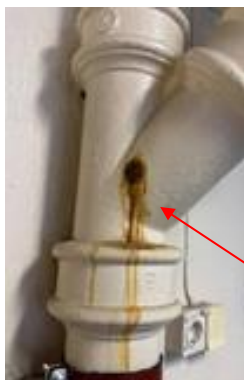
Avløpsrør med rustdannelser
