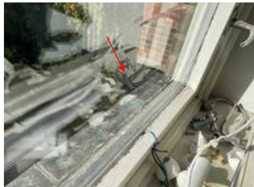
Manglende vedlikehold inn/utvendig
