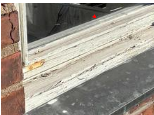
Store mangler på vinduer i 9 etasje
