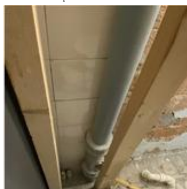
Viser gamle stigerør ikke blir skiftet ut.
