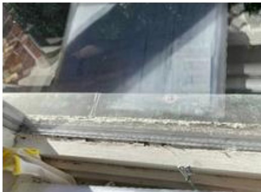
Vinduer fra antatt midt av 60 tallet
