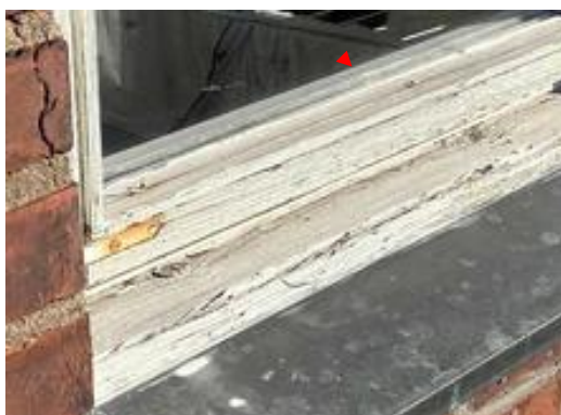
Store mangler på vinduer i 9 etasje
