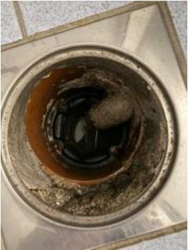
Sluk i plast i bad.
