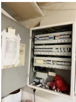
Sikringskap er plassert i underetasje/hybel 1. Kursoversikt på innside skapdør.
