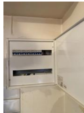
Sikringskap er plassert i hybel 2, i stue.
