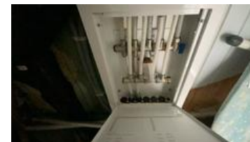
Rør i rør fra 2014. Ingen avvik på anlegget.
