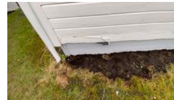
Det er råte i nederste bord mot hage badevegg.
