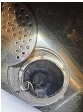
Sluk på bad i 2. etasje.
