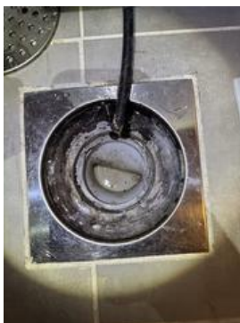
Sluk på vaskerom i underetasjen.
