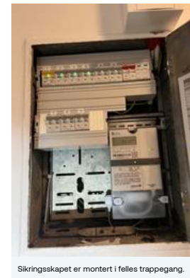
Sikringskapet er montert i felles trappegang.
