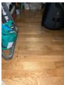
Bruksmerker/slitasje på parkettgulv i boden. TG 2
