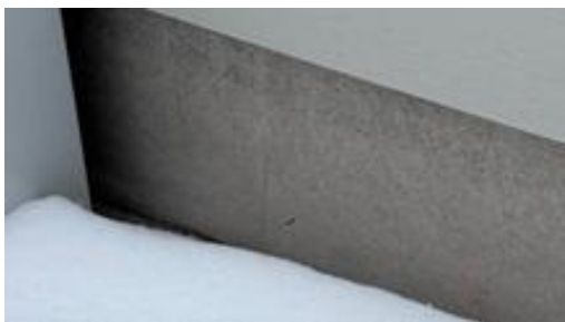
Mindre/riss sprekk på grunnmursplate
