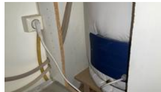
Synlige del av vvb
