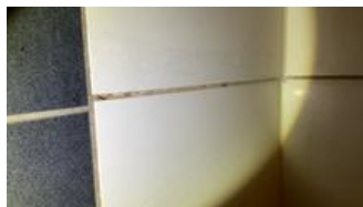
• Slitte og utvaskede flisfuger.
