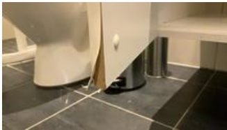
Det er påvist skader på innredning.
