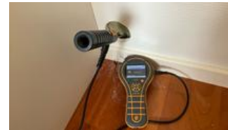
Ingen utslag ved fuktmåling i hulltaking i vegg mot badet. Målingene som er gjort er å betrakte som stikkprøver og sier bare noe om tilstanden i nærheten til området der målingen er utført.
