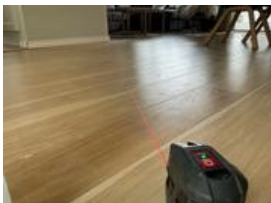
Nivellering stue/spisestue + kjøkken, avvik ca. 15-30 mm
