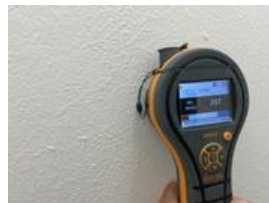
Fuktsøk på betongvegg i trapperom, utslag.
