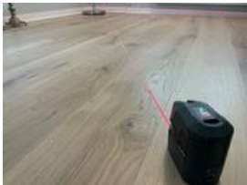
Nivellering soverom, avvik ca. 10-20 mm
