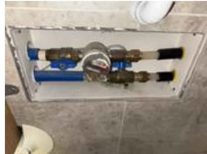
Stoppekraner i servantskapet.
