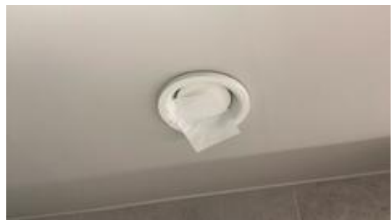
Test av avtrekk. Papiret henger.
