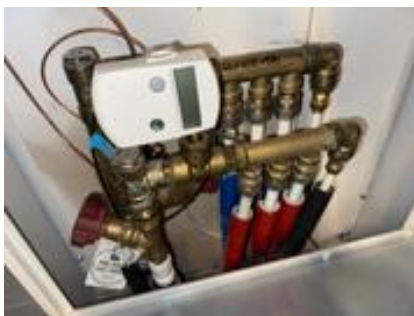
Rørskap i garderoben.
