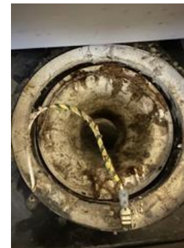
Sluk i vaskerommet.
