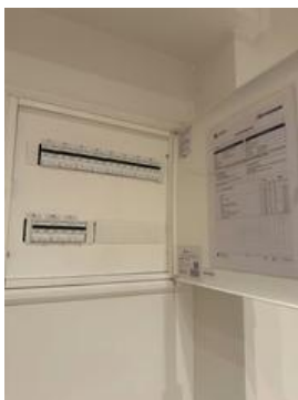
Sikringskap med automatsikringer i gang 1. Kursfortegnelse på innside av skapdør.
