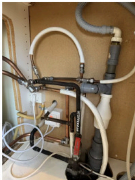
Kobberrør og inntak med stoppekran.
