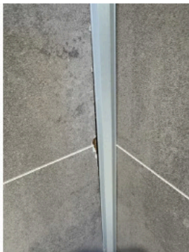
Avvik på hjørner til baderomsplater.
