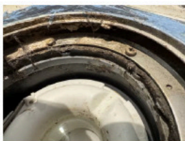
Synlig tettesjikt i sluk.
