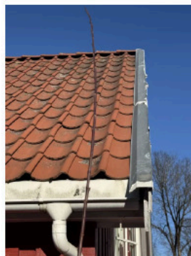
Slitasje på beslag over vindskier.
