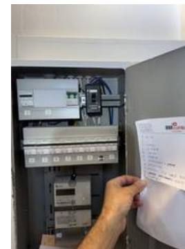
Sikringskap er plassert i felles trappeoppgang.
