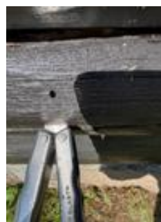
Råteskader og hull etter skadedyr.
