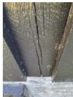
Panel er ikke luftet og har sprekker og slitasje.
