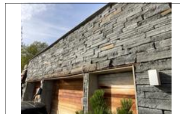
Rustspreng over port, bom/hullyd under skifer steiner, falmet porter og dør. TG2, noe fremtidig vedlikehold må påregnes.
