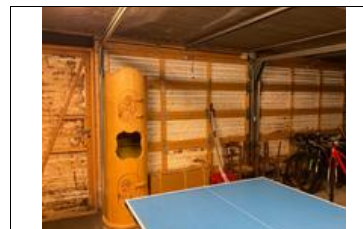
Skjolder, fuktmerker på dører, himling, dekke, vegger. Dårlig ventilering. TG2. Ytterligere kontrollrom undersøkelser anbefaies.
