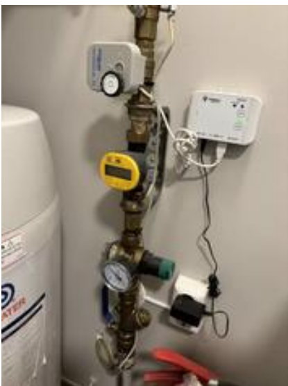
Vannmåler og hovedstoppekran plassert lett tilgjengelig på teknisk rom.
