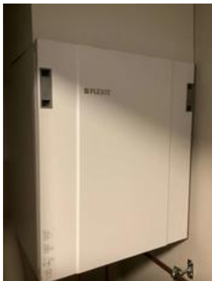
Ventilasjonsaggregat plassert i vegg på teknisk rom.
