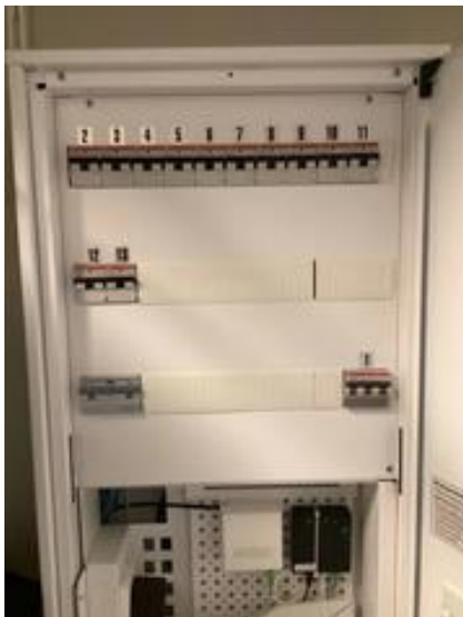
Sikringsskap med automatsikringer plassert i bod.
