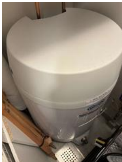
Varmtvannsbereder plassert på teknisk rom, i rom med sluk.
