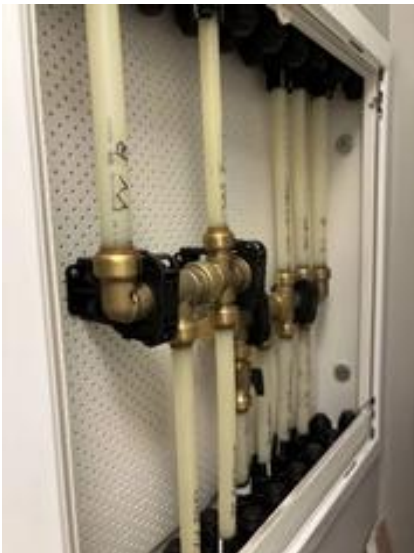
Rørfordelerskap plassert på teknisk rom.
