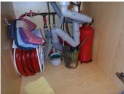
Avløpsrør i kjøkkenbenken
