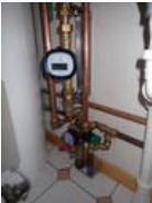
Stoppekran samt kobberør og vannmåler
