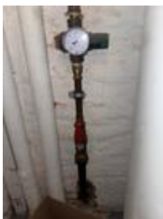
Inntaksrør med hovedstoppekran.
