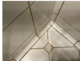
Sprekk i fliser i våtsone
