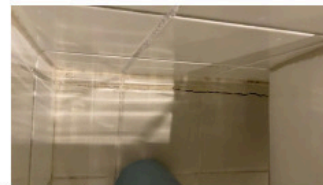
Ris i fug under toalett
