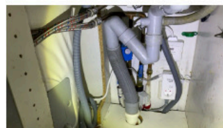
Hovedstoppekran plassert under kjøkkenvask
