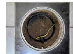
Hjelpesluk foran servantinnredning
