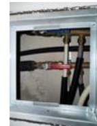
Inspeksjonsluke til røranlegg og stoppekraner i himling på bad/wc.
