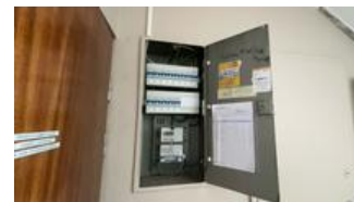
Sikringsskap plassert i felles oppgang.
