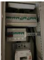
Sikringskap i felles trapperom.
