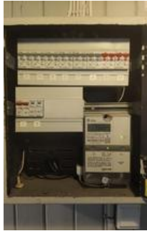
Elektrisk anlegg - [Sikringskap]
