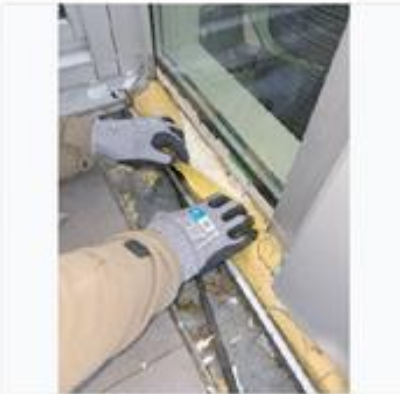
Foto 24 Det var ingen fukt på selve isolasjonen, men noe fukt rogstreut på trevirke bak.
