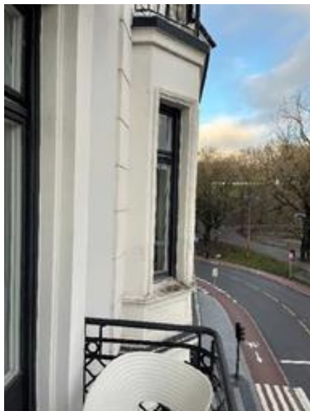
Riss og sprekker på karnapp
