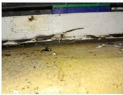
Foto 26 Oppbrett under vinduet er løs og ikke tett med tettemasse.
