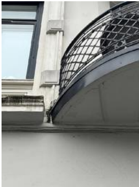
Skader ved balkong
