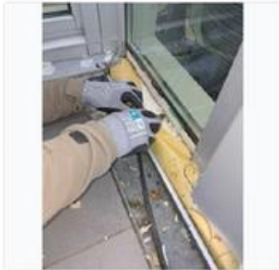
Foto 23 Membranen ble løst for kontroll.
