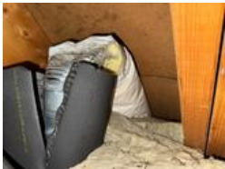
Avtrekksskanal på loft
