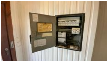
Automatsikringer i el skap fra 2016.
