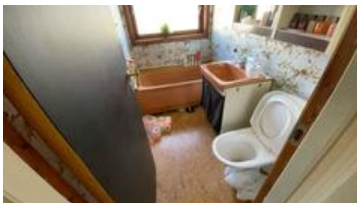
Badet fra 1954 må renoveres grunnet alder. ETASJE 2 > BAD
