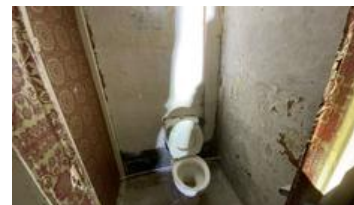
Wc må renoveres og montere el-vifte + mangler dør.
