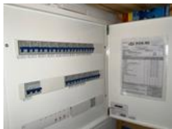
Automatsikringer i sikringsskap plassert i bod.
