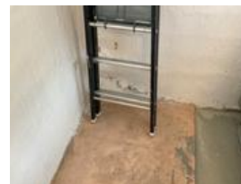
Saltutslag på vegger
