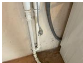
Saltutslag på vegger
