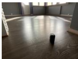
Nivellering stue/kjøkken 2 etasje, avvik ca. 10-20 mm
