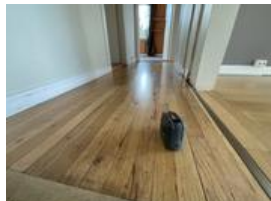
Nivellering gang, avvik ca. 10-20 mm
