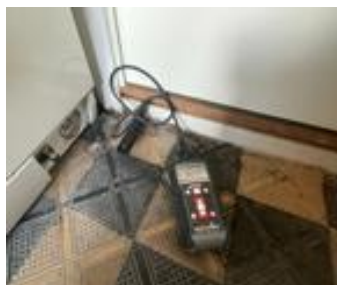
Fukt under dør kommer trolig i fra oppsug i grunn
