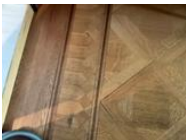
Svikt i underlag ved inngang til kjøkken
