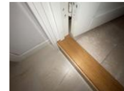
Luftspalte under dørradet.
