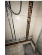
Krom kobberør på baderom.
