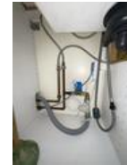
Rør på kjøkken. Lekkasjestopper.
