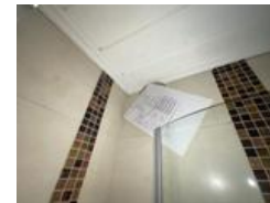
Test med løst ark viste tilfredstillende avtrekk.
