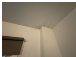
Luftlekkasje ved innkassing på ett soverom.
