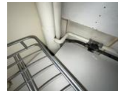
Stoppekraner på kjøkken.
