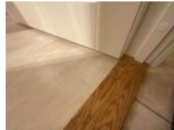
Luftespalte under dørbladet.
