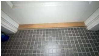
Ingen spalte for tilluft
