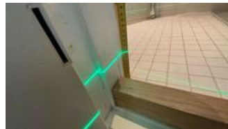
Høydeforskjell (flis ved terskel)
