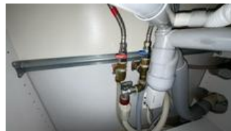
Stoppeventiler på kjøkken
