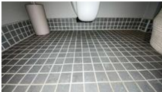
Ingen løsning for lekkasjesikring
