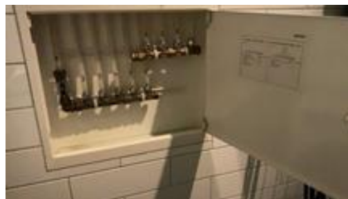
Fordelerskap for vann plassert på bad.
