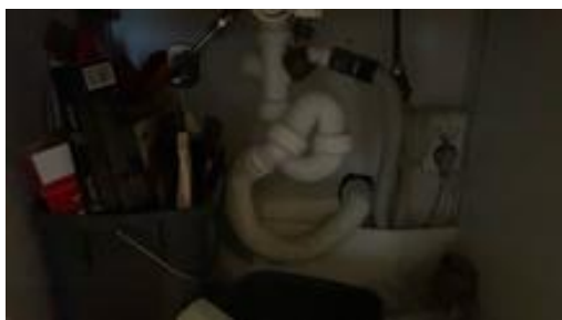
Rørinstallasjoner i kjøkkenbenk
