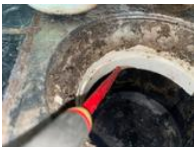
Sluk under dusjkabinett.
