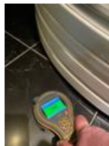
Fuktsøk på gulv foran dusjkabinett.
