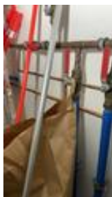
Hovedstoppekran på felles teknisk rom, adkomst felles gang.
