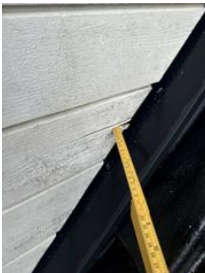
Råteskade i bordkledning.
