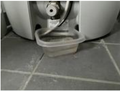
Drypplekkasje fra varmtvannsbereider.
