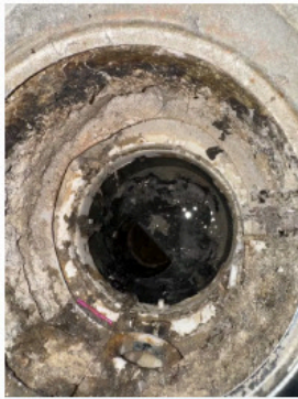
Sluk på bad.
