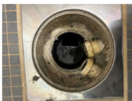
Sluk på bad i hybel 3.
