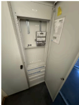
Sikringskap er plassert i felles gang.
