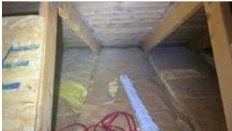
Isolasjon dekker delvis lufting mot raft. Dårlig lufting og luftlekkasjer kan erfaringsmessig gi kondensskader og isdannelser på den kalde årstida.
