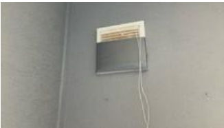
Ventil bør sjekkes nærmere da den er tapet på befaringen
