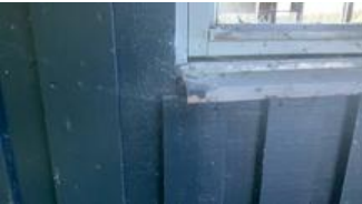
Glipper mellom vannbrett og vinduer gir økt risiko for fukt-/vanninntrenging i konstruksjonene.
