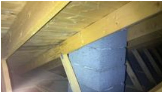
Fuktmerker er registrert ved gjennomføringer. Gjennomføringer i tak må kontrolleres for å kartlegge årsak til misfarging/fuktmerker.
