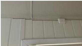
Innvendige overflater fremstår med manglende håndverksmessig utførelse flere steder.
