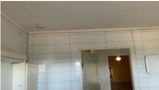
Ufagmessige arbeider er påvist flere steder.
