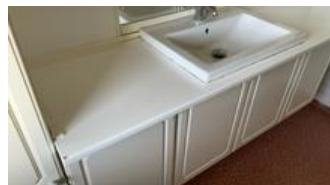
Innredning har skader.
