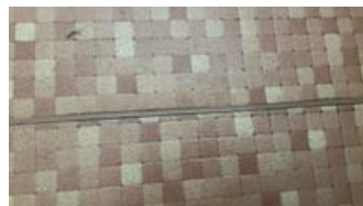
Sprekk i membran, våtrommet er utett.
