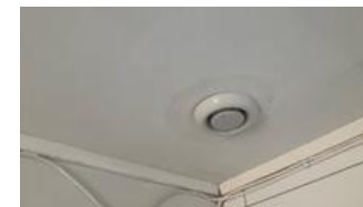
Fuktmerker rundt ventil i taket.
