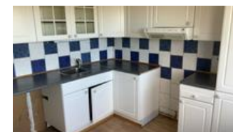
Eldre innredning. Innredning bærer preg av slitasje. Ufagmessige arbeider er påvist.
