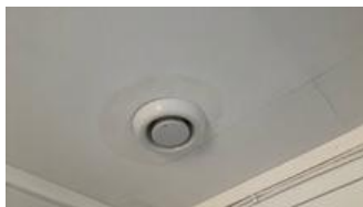
Fuktmerker rundt ventil i taket.
