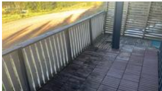
Skjevheter er registrert i fundamenter og konstruksjoner.
