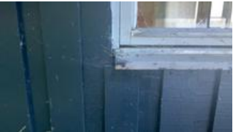
Det er ufagmessig utførelse på beslag på vannbrett.
