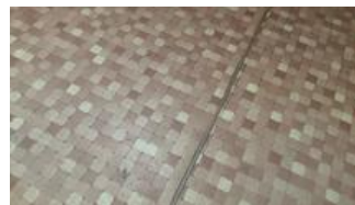
Sprekk i membran, våtrommet er utett.
