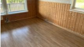
Ufagmessige arbeider er påvist flere steder.
