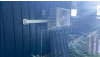
Viktig å lede vann fra varmepumpe bort fra grunnmuren.
