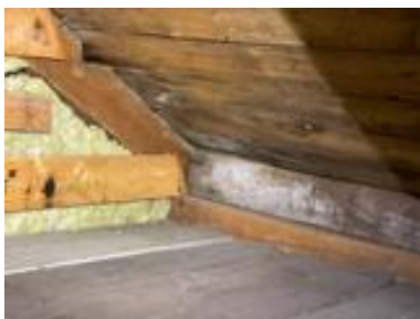
Soppdannelser i undertak, over stuen.
