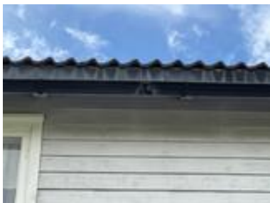
Symptom på punktvis lekkasje i overgang.
