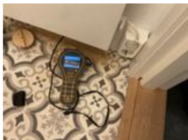
Fuktmåling i veggkonstruksjonen fra WC
