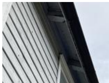
Soppdannelser og avflasket maling i takkonstruksjonen.
