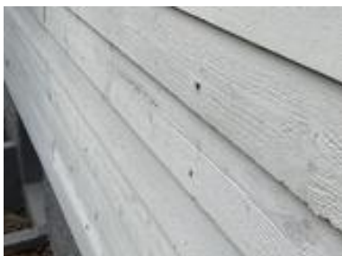
Spikere som ikke er langt nok inn mot panelet.
