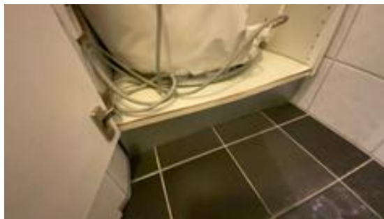
Noe fuktsvelling og nedbøyning i hylle/seksjon hvor VB står.
