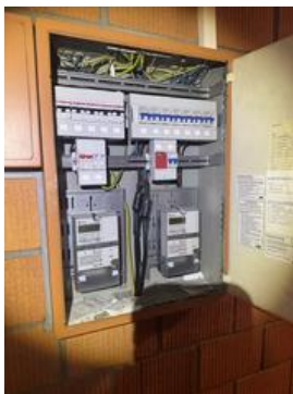
Sikringskap i felles oppgang.
