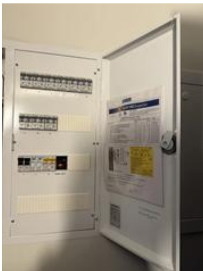
Sikringsskap er plassert i bod. Kursoversikt på innside skapdør.
