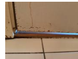
Baderomsdør er noe påvirket av fukt i nederkant.
