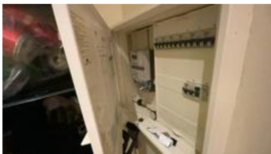
Automatsikringer i el skap fra byggeåret.
