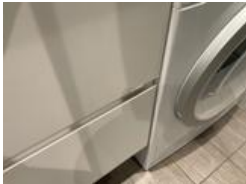
Noe påbegynte svellinger i baderomsinnredning.
