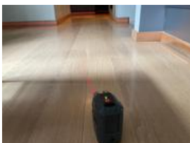
Nivellering loftsetasje, avvik ca. 15-30 mm
