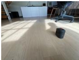
Nivellering stue/kjøkken, avvik ca. 10-20 mm
