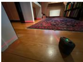
Nivellering trapperom, avvik ca. 10 mm.
