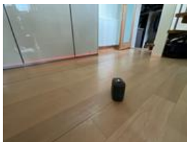
Nivellering stue, avvik ca. 10-20 mm
